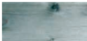
Unbehandelte Oberfläche Folge: Holz vergraut vollflächig
