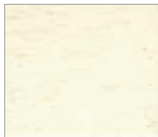
OHNE Isoliergrund verfärbt sich die Oberfläche gelblich.
